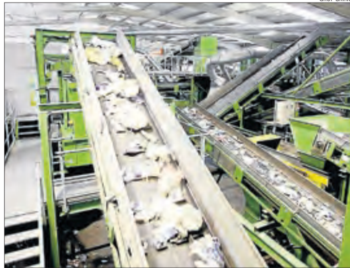
Planta de tratamiento de residuos del Grupo Griñó.
